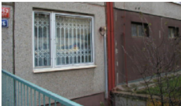
Vnitřní nůžková okenní mříž
