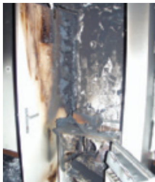
Požár bytu od závady na lednici
