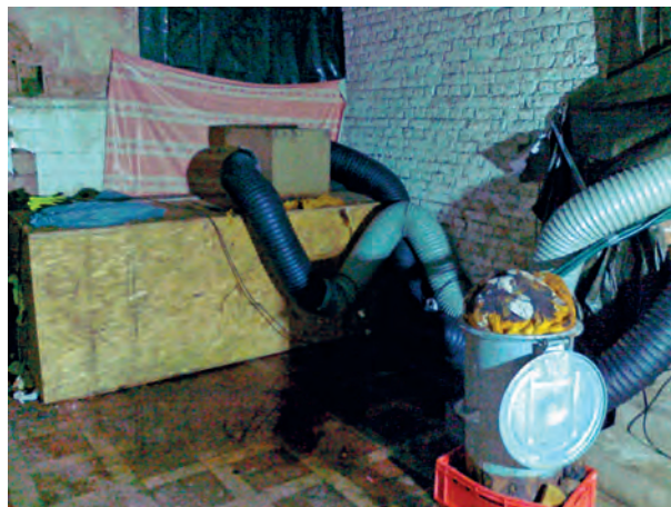
Obr. 1 Filtr s kondenzační nádobou – všimněte si louže kys. fosforečné na podlaze a koroze na plášti kondenzační nádoby (foto VAKOS XT)
