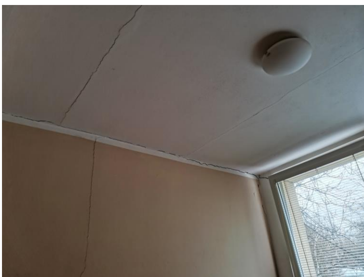
obr. 9 Trhliny ve stropě 2.NP
