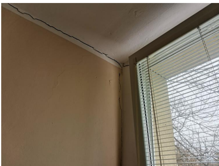
obr. 10 Trhlina v SZ rohu v 2.NP
