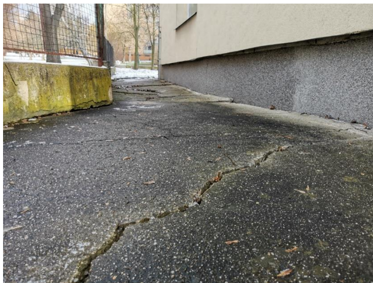
obr. 4 Deformovaný chodník u západního štítu
