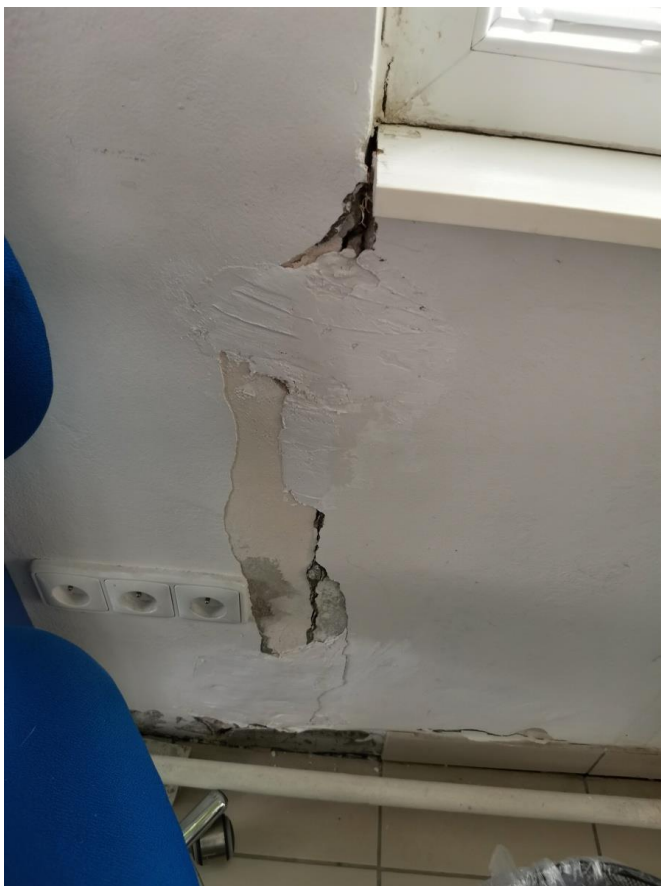
obr. 8 Trhlina v 1.NP v parapetu okna v severním průčelí
