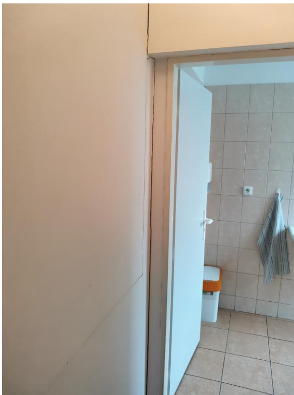
obr. 6 Nová trhlina na WC v 2.NP
